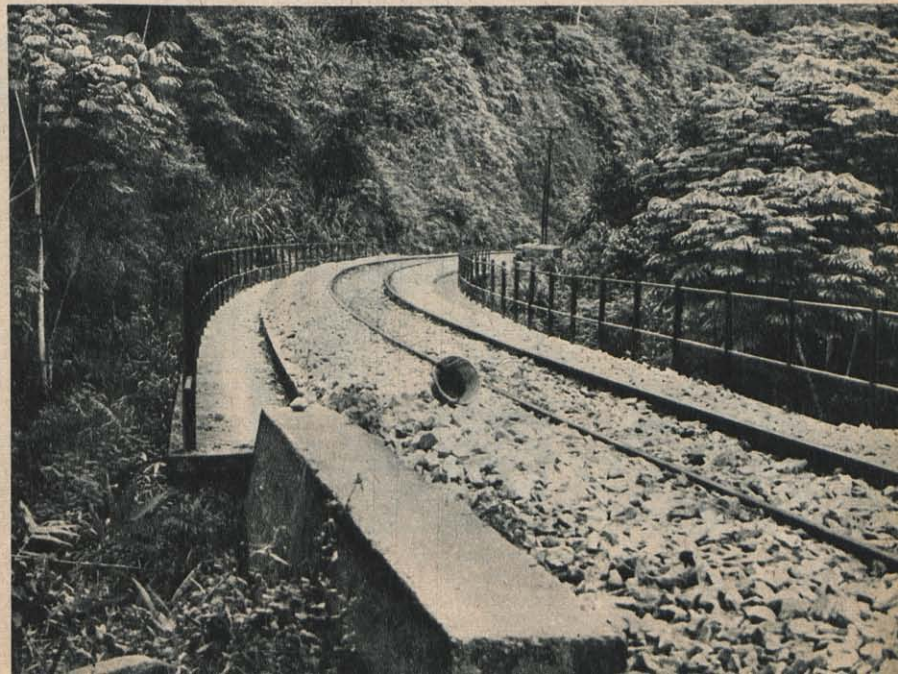
Mayombé : le viaduc du km. 119. Les coteaux surplombant la voie sont sujets à de fréquents éboulements en saison des pluies, entravant ainsi toute circulation.
